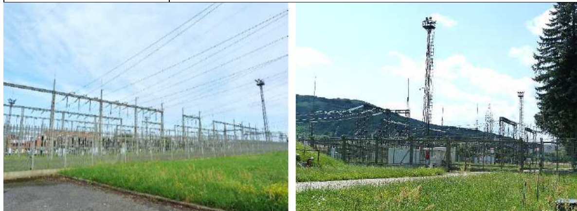
Felsőzsolca és Sajóivánka 400/132 kV-os alállomások
